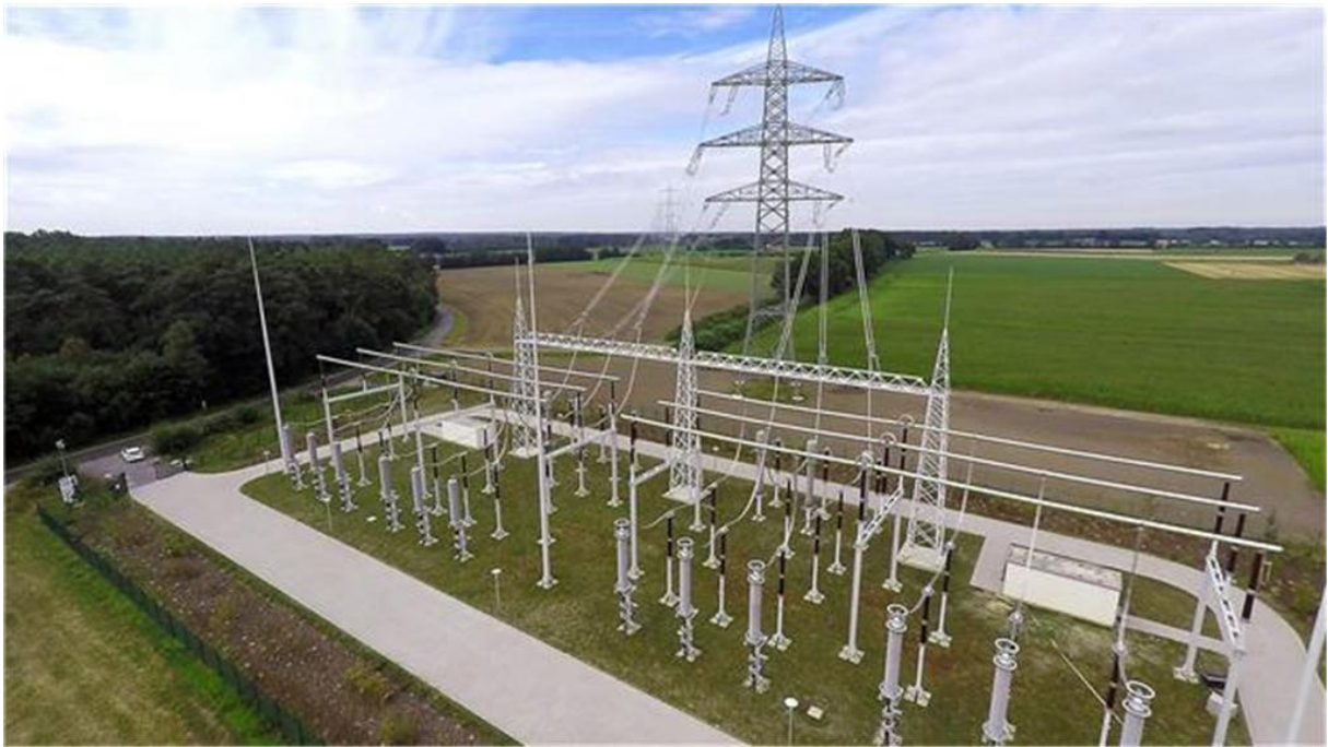
Abbildung 4: Höhenunterschiede zwischen einem 380-kV-Mast und einer Kabelübergabestation (KÜS) bei Raesfeld im Münsterland (Amprion GmbH 2019).
